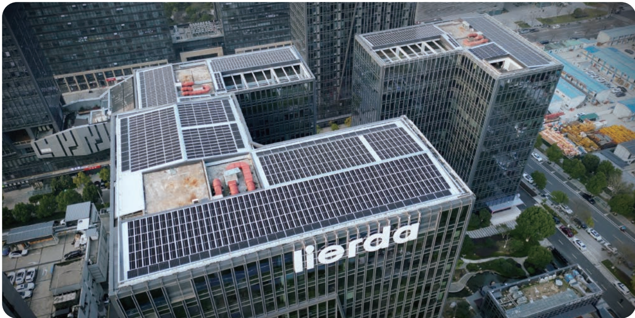
265KW Local: Zhejiang, China Data de instalação: 2024 Tipo de projeto: C&I - (BIVP)
